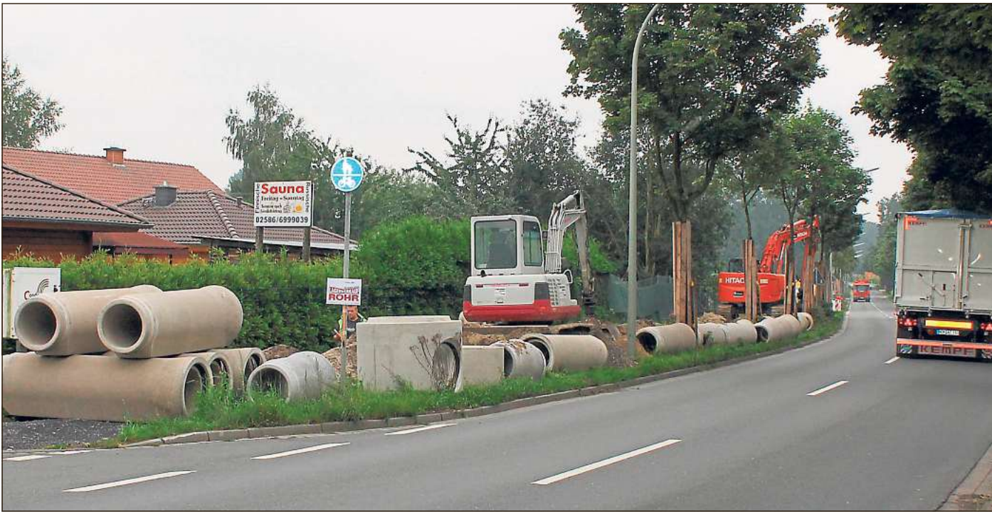
Auf dem Westring ist seit einigen Wochen ein Unternehmen damit beschäftigt, Rohrsysteme im Erdreich unterzubringen. Diese Firma soll vermutlich auch die Arbeiten an den Zufahrten zum Tich vornehmen.
